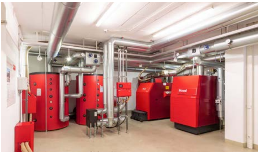
Heizen. Kühlen, Lüften: Die neue Hybridlösung sorgt im Headquarter von Hoval Deutschland für angenehme Temperaturen.
