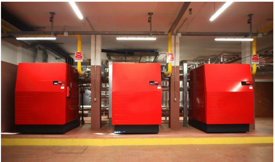
Drei UltraGas® Brennwertkessel versorgen das Arealnetz mit Wärme für Heizung und Warmwasser.
